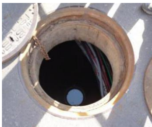
(d) 电力电缆井
